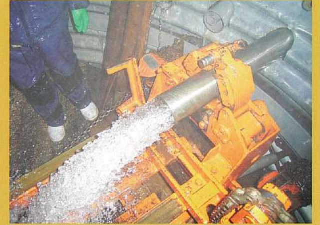
集水井内の集水状況
