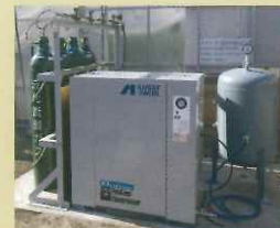
CO 2 とAirの混在制御設備
